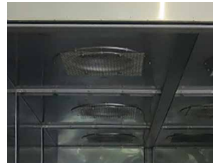
Große Ventilatoren im Innenraum
