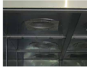
Große Ventilatoren im Innenraum
